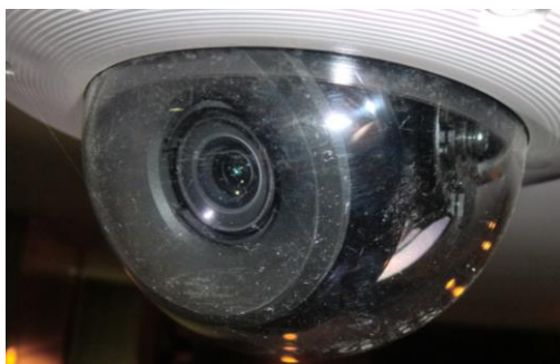
図13-1 設置時にドームクリアの内面が汚れた例
