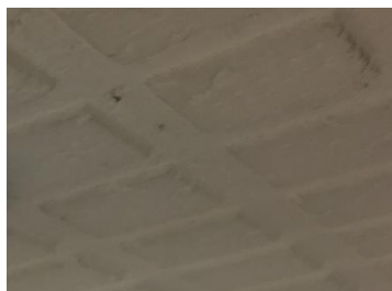
凸凹している天井
